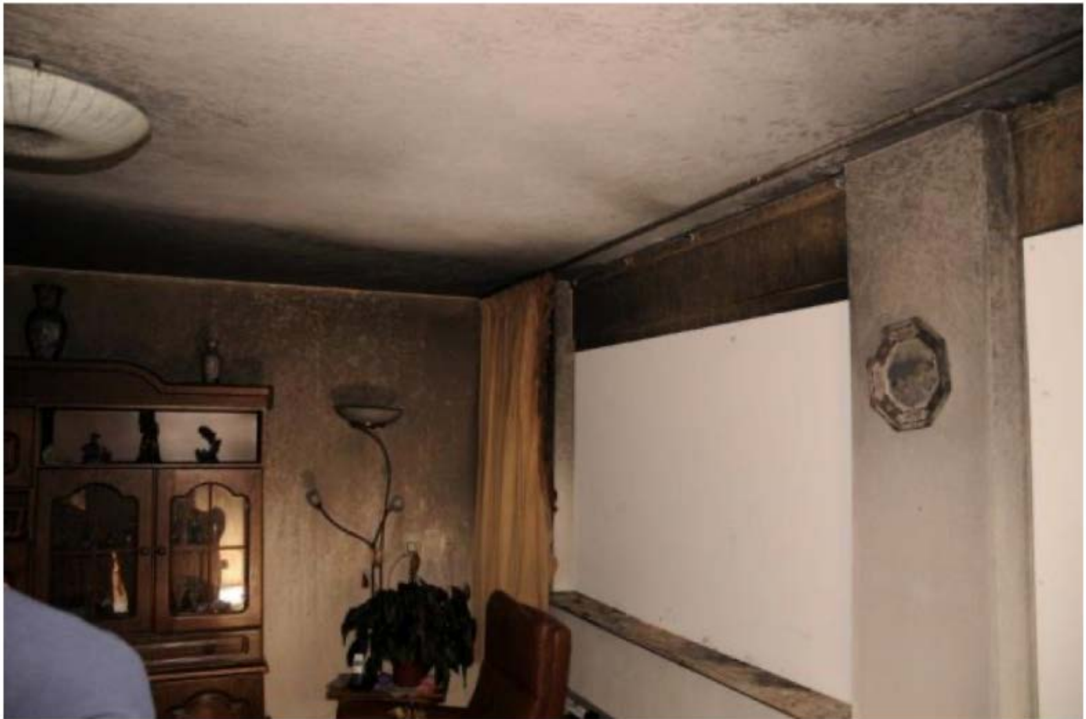
Foto 10: Brandwoning 2 e verdieping
