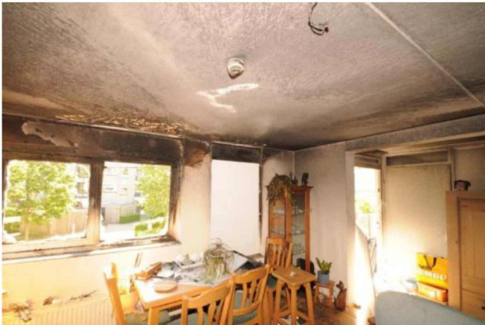
Foto 8: Brandwoning 1 e verdieping
